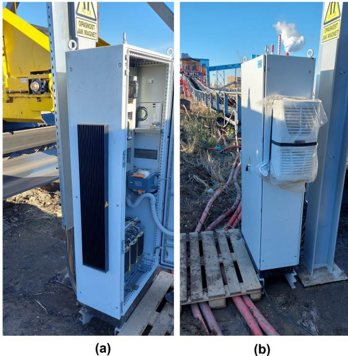
Slika 13. Prikaz razvodnog ormara energetike +ROE (napajanje snažnog elektromagneta i pripadajućeg pogona transportera); (a) bočni izgled +ROE na kome je montiran hladnjak trofaznog diodnog ispravljača, (b) bočni izgled +ROE na kome je montirana njegoa rashladna jedinica
