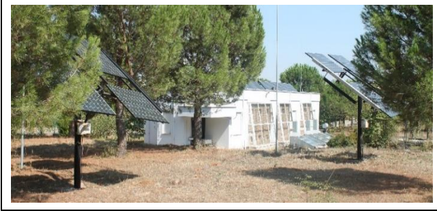
Şekil 6. İzleyicilerin üzerinde konuşlu fotovoltaik modüller. Figure 6. Tracker mounted photovoltaic modules.
