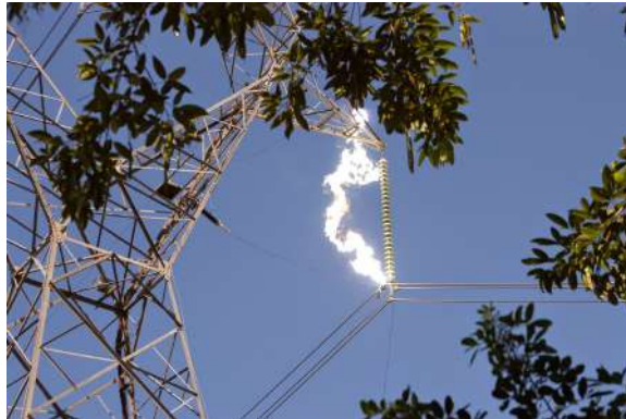
Figura 2. Arco eléctrico en cadena de aisladores
