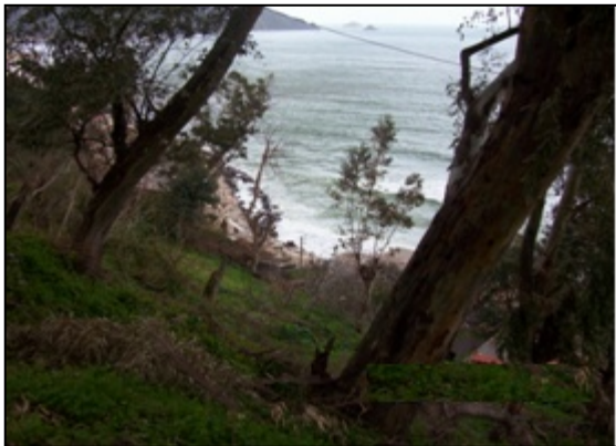
Photo.1- Glissement de terrain sur le versant de Stora (2005)
