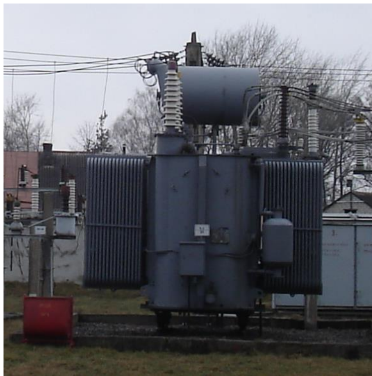
Рисунок 1 – Трансформатор ТРДН-25000/110 на ПС-110 «Занеманская».
