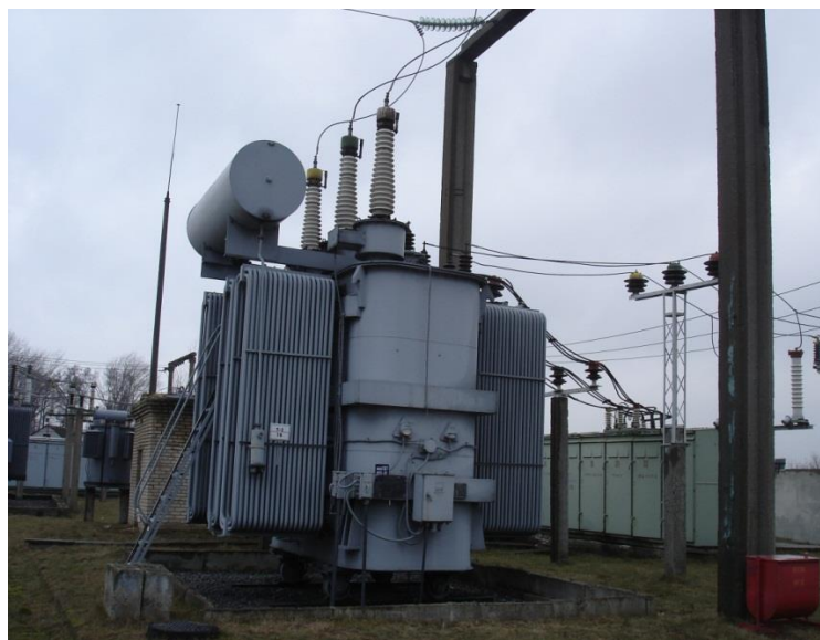
Рисунок 2 – Трансформатор ТДТН-16000/110 на ПС-110 «Занеманская».
