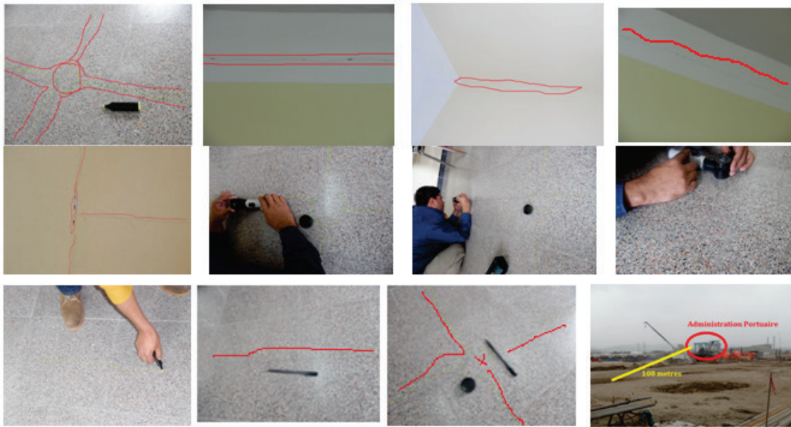
Fig. 26 – Photographies des fissures dans l'administration portuaire résultant de DC
