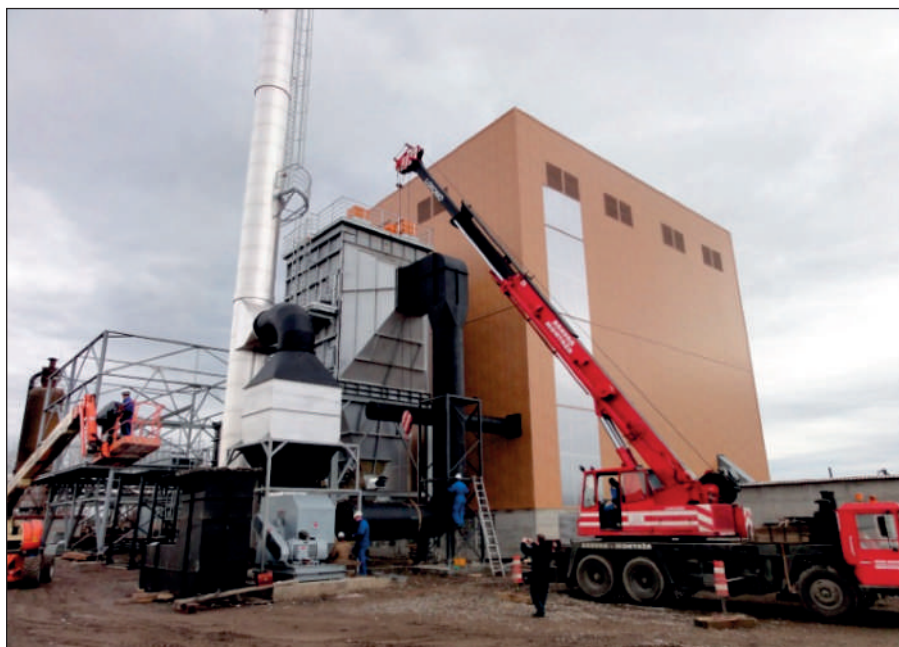
Slika 7. Bioelektrana-toplana Strizivojna: 3,3 \text{ MW}_{\text{el}} i 6 \text{ MW}_{\text{topl}}
