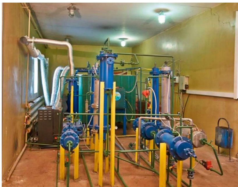
Общий вид установки СВЧ-термолиза
