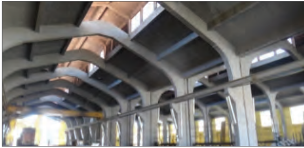
Şekil 49 Tren Bakım İstasyonu iç mekân, 2013
