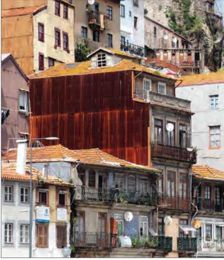
Portekiz - Porto şehrinde paslanmış ve akmış teneke cephe
