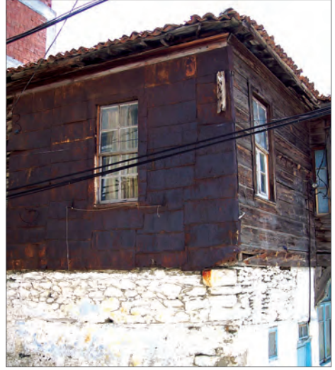
Balıkesir - Marmara Adası'nda paslanmış ve akmış teneke cephe
