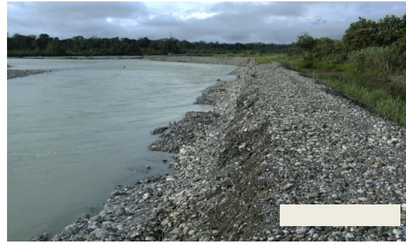
Gambar 11 Tanggul Kali Braza yang dibangun tahun 2011, saat ini telah hilang (2013)
