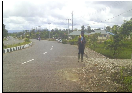
Gambar 2 Kondisi jalan Kabupaten Yahukimo
