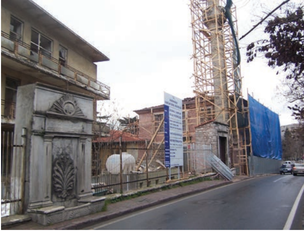
Resim 7. Bezm-i Alem Vakıf Guraba Külliyesi 'nde 2007'de çeşme ve cami onarımı. (H.Turhan Arş.)
