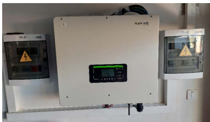
Slika 9. Slika solarne elektrane
