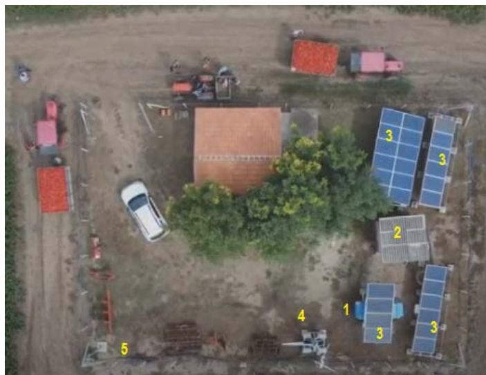
Slika 17. Realizacija hibridnog sistema napajanja banke na poljoprivrednoj parceli Smart Land -„Belegiš“ sa pojedinim funkcionalnim celinama: (1) baterijska banka, uređaji energetske elektronike i merno-regulacioni deo, (2) prostorija za smeštaj razvodnog ormara pumpnog agregata sa frekventnim regulatorom i razvodnog ormara DEA, (3) sistem solarnih panela 12x250W i 4x350W, (4) montažni stub sa VG snage 500W, (5) meteorološka stanica
