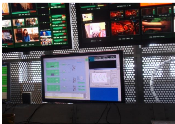
Fig. 3. Monitoring Centre of Cyfrowy Polsat S.A. (Warsaw) [29]
