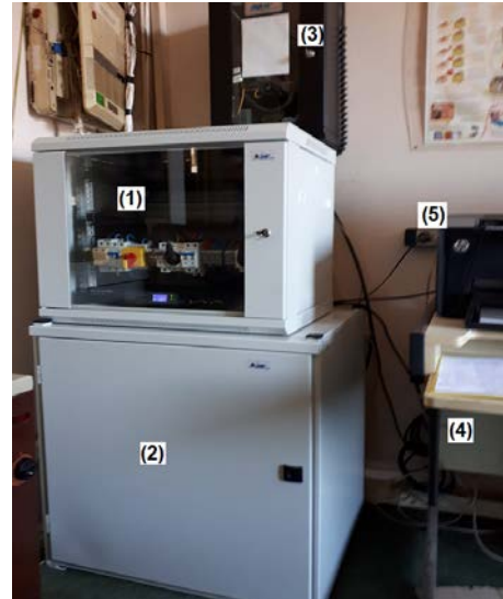
Slika 17. Izgled realizovanog energetskog ormana BPN u KUC Valjevo
