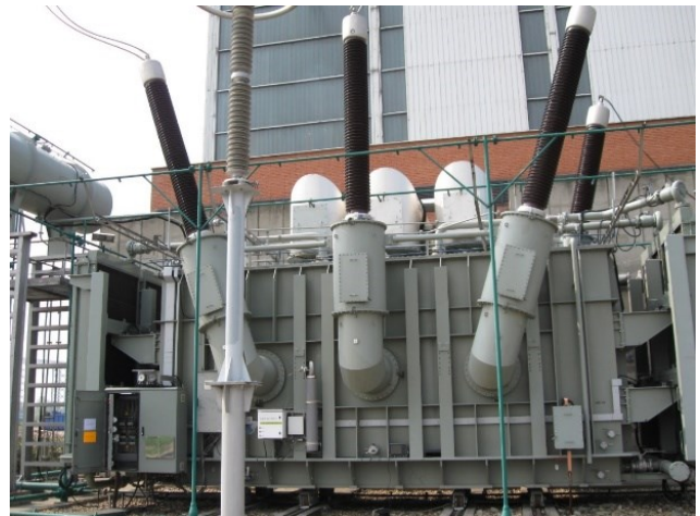
Slika 8 – Blok transformator naznačene snage 725 MVA.
