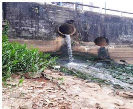
Figura 2 – Despejo de esgoto doméstico
