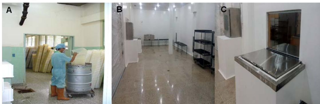
Figura 11. Área de acondicionamiento de equipos. A: Antes de la remodelación, ubicado en pasillo de circulación y paredes cubiertas con baldosa. Área de acondicionamiento de equipos. B-C: después de la remodelación, incorporación de tanque germicida y eliminación de baldosas, acabado de pintura epóxica
