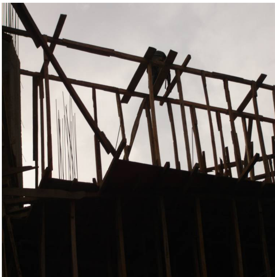
Fotografía 4. Carpintero armando encofrado con riesgo de caída.
