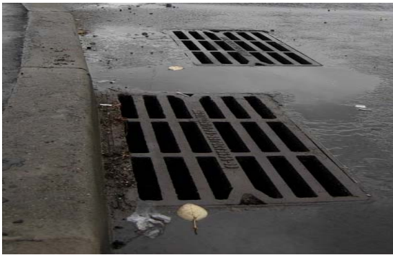
Рис.4. Водоприймальний колодязь точкової системи водовідводу на проспекті Карла Маркса
