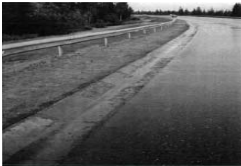
Рис.2. Поверхневий лотковий водовідвідна магістралі по вул. Криворізьке шосе
