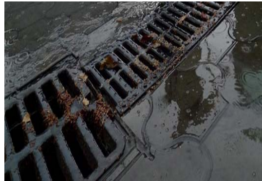
Рис.5. Водоприймальний лоток лінійної системи водовідводу на Європейській площі
