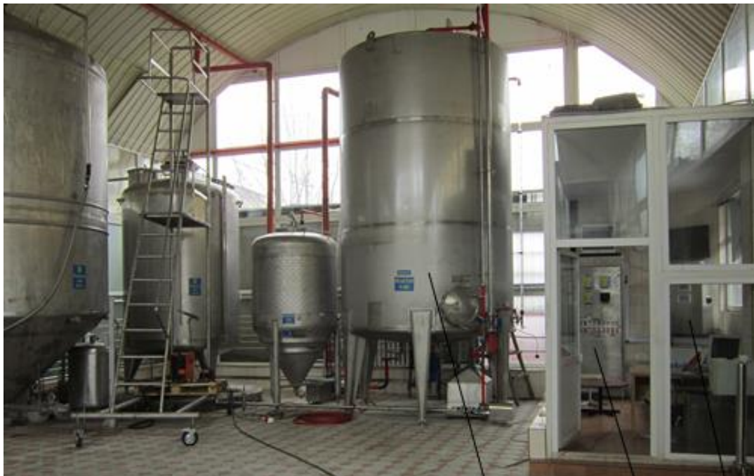
Рис. 4 Цех производства натурального уксуса. Операторская 1 - щит КИПиА автоматизированной системы управления цехом; 2 - щит управления реактором 3 фирмы Frings.
