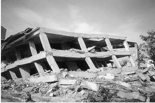
Şekil 1: Tipik kolon-kiriş birleşim bölgelerinin göçmesi [4].
