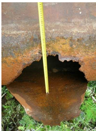
Фиг. 1. Корозионни поражения по тръба от газопровода
