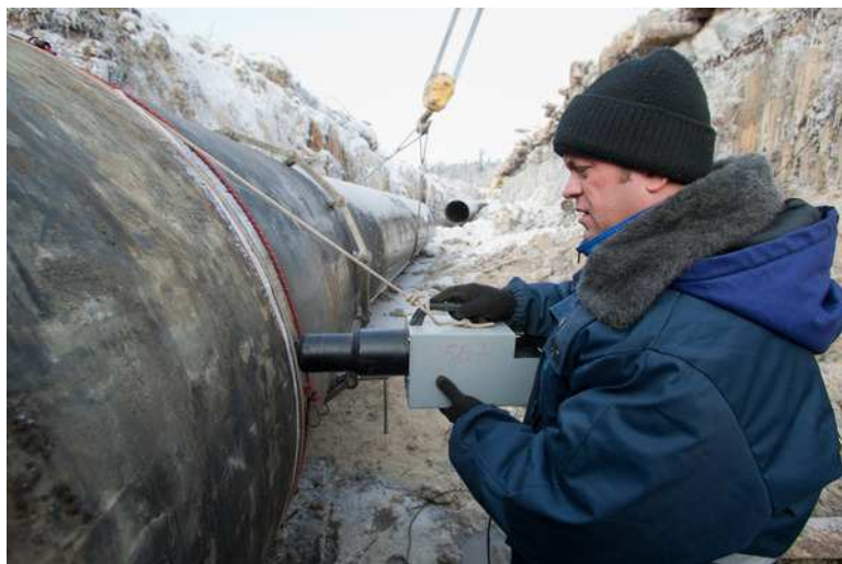
Фиг. 5. Установяване на дефектоскопа за безразрушителен контрол на заваръчно съединение на тръбопровод
