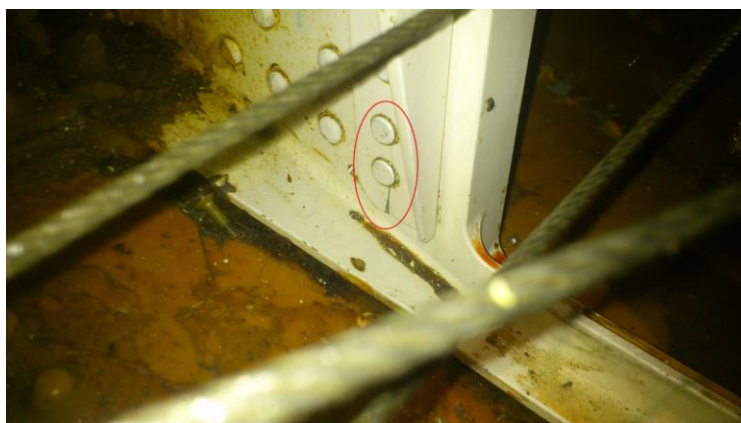
Rys. 14. Pęknięcie wręgi BS 616 tuż pod prawą belką odwróconą
