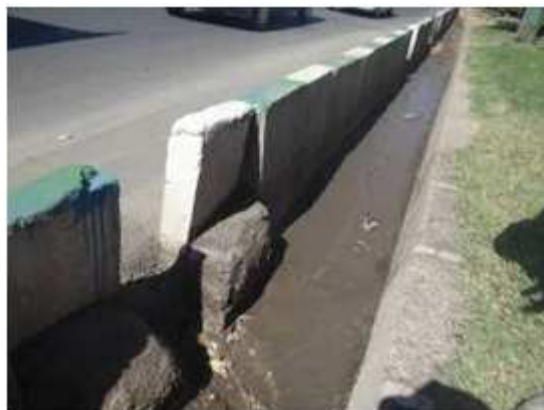
شکل ۱۱. وجود آب و لجن در جوی کنار محل ریزش
