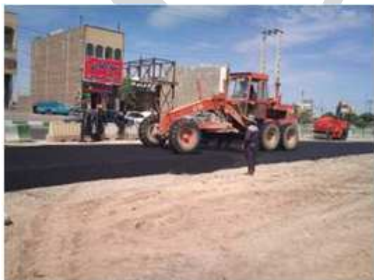
شکل ۴۱. آسفالت خیابان در محل ریزش
