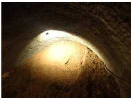
شکل ۱۶. ورود خاک محل ریزش به داخل تونل
