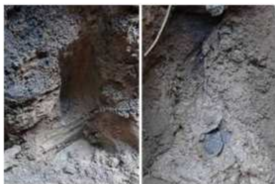
شکل ۱۴. نشست آب در داخل تونل
