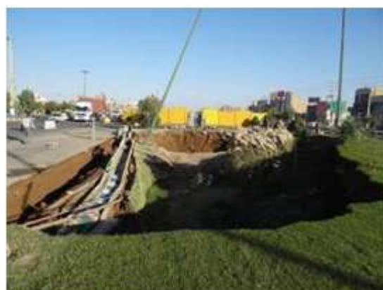
شکل ۱۲. نشست تونل در سطح بلوار
