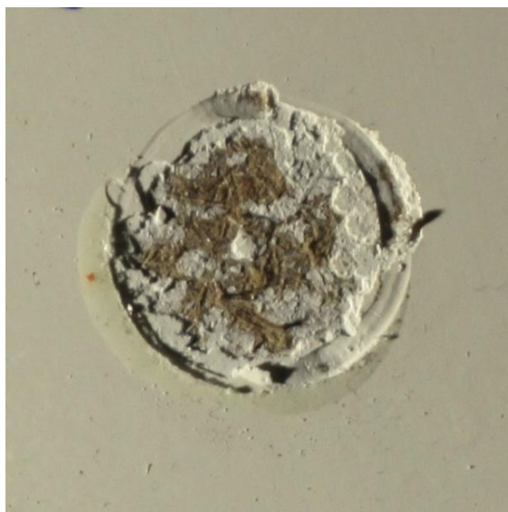
Фото 10. Отрыв ORIGINI от PUTZGRUND. Толщина оторванного слоя 400 мкм, адгезия 0,8 МПА
