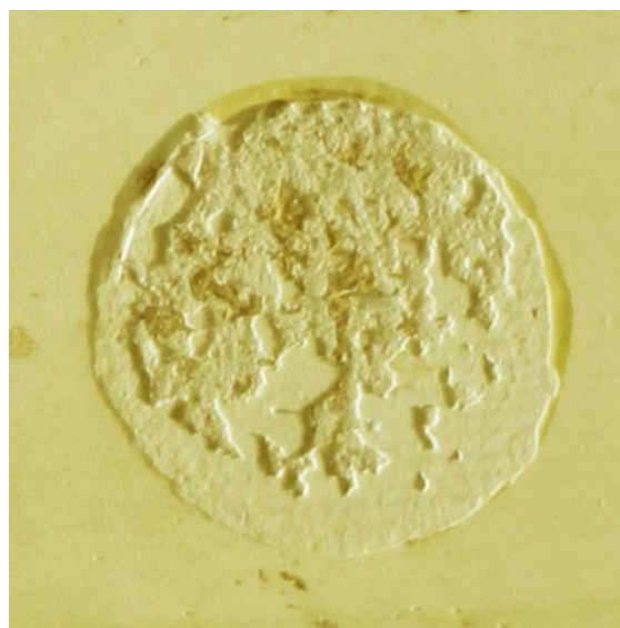
Фото 15. Отрыв VIVALDI STUCKY от FARINA DI QUARZO. Толщина оторванного слоя 270 мкм, адгезия 0,7 МПа
