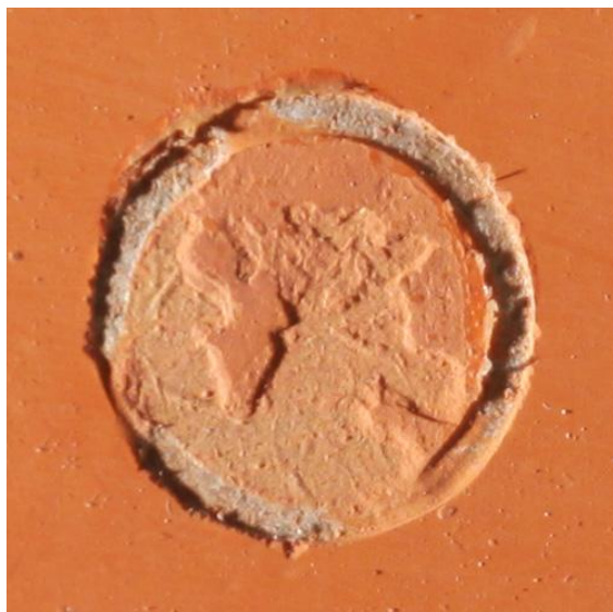
Фото 9. Отрыв VENEXIAN от PUTZGRUND. Адгезия 1,0 МПА
