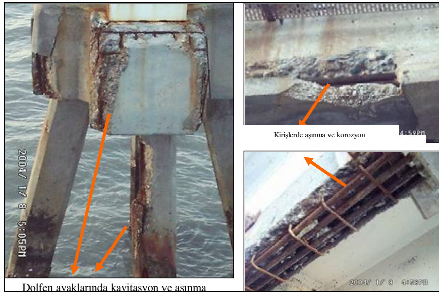
Resim 2. Kerkük-Ceyhan petrol boru hattı ceyhan platformunda hasar.
