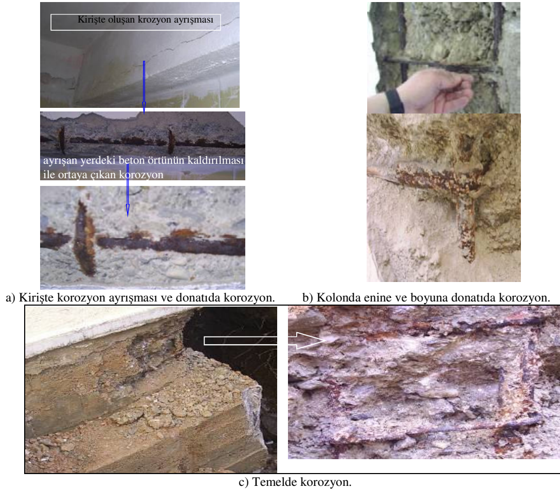
Resim 1. Kullanılmakta olan bir okul binasında tespit edilen korozyon.
