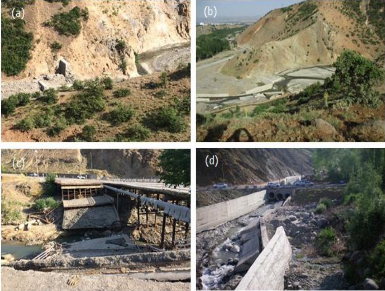
Şekil 2: 13.04.2017 tarihinde Çapakçur Çayı'nın taşması ve sel sonucu su yapılarında oluşan tahribatlar: (a) mamba tersip bendi, (b) mansap tersip bendi, (c) akarsu geçiş köprüsü, (d) taşkın kontrol tesisi (Foto: DSİ 9. Bölge Müdürlüğü)
