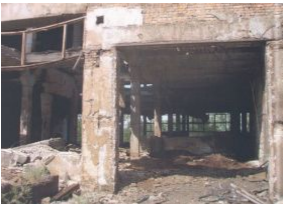
Рисунок 1 – Зруйнована будівля на території СХЗ
