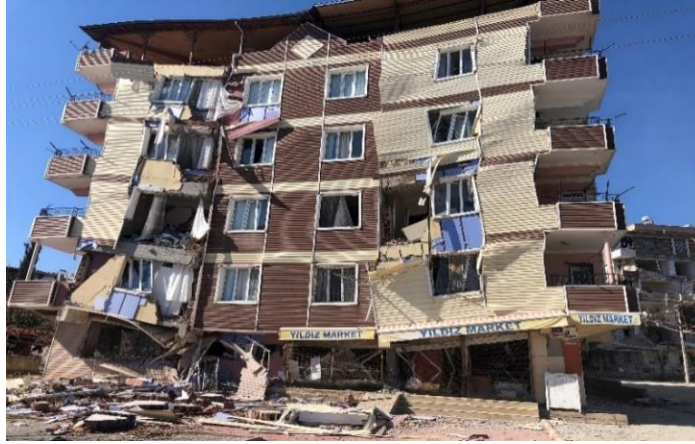
Şekil 1: Ağır hasarlı yapı örneği Nurdağı Yeni Mahalle
