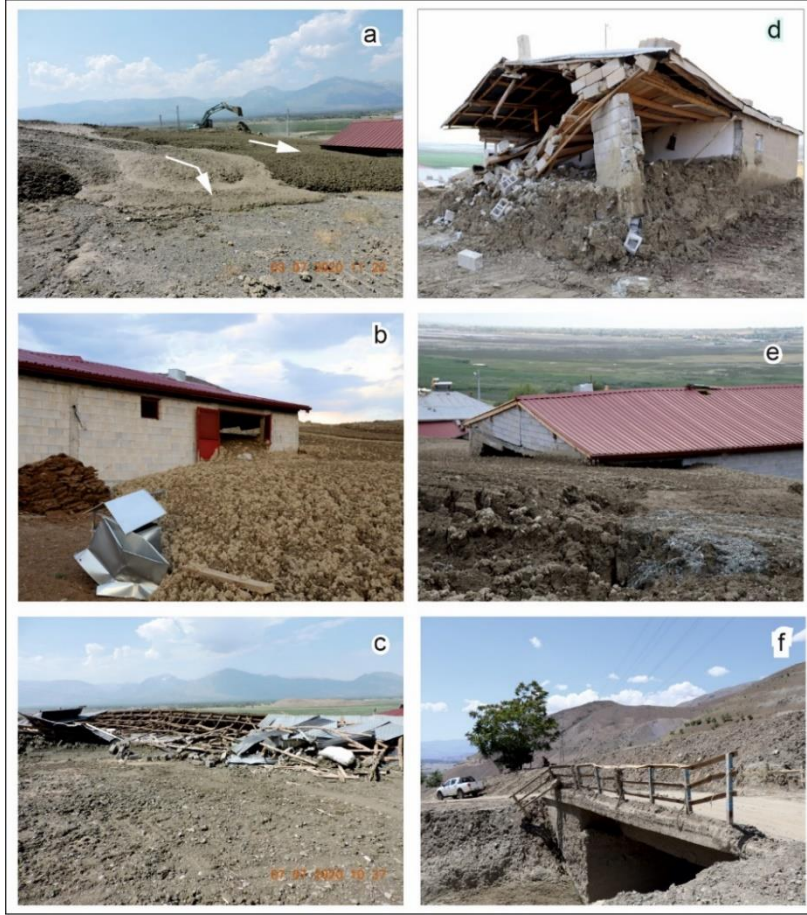
Şekil 5: Günebakan sel-taşkın olayında çok sayıda konut ve ahır büyük zarar görmüştür (a, b, c, d, e). Günebakan Dere üzerindeki beton köprü'nün demir korkulukları eğilmiş, bağlantıları kopmuştur (f).
