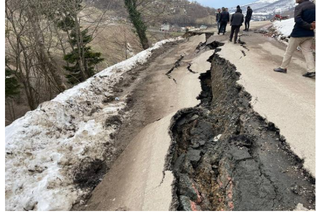
Şekil 2: Düzköy ilçesi Çayırbağı-Yusuflu karayolu heyelan (30.03.2022) (URL-2 2022)
