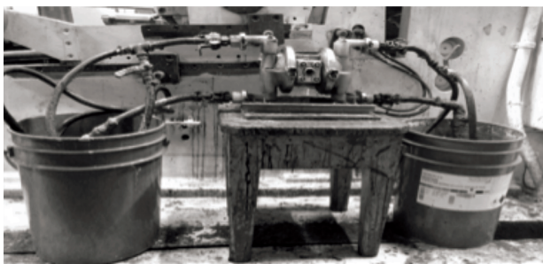
Fotografía. 3 Sistema de alimentación de tintas y bombas neumáticas
