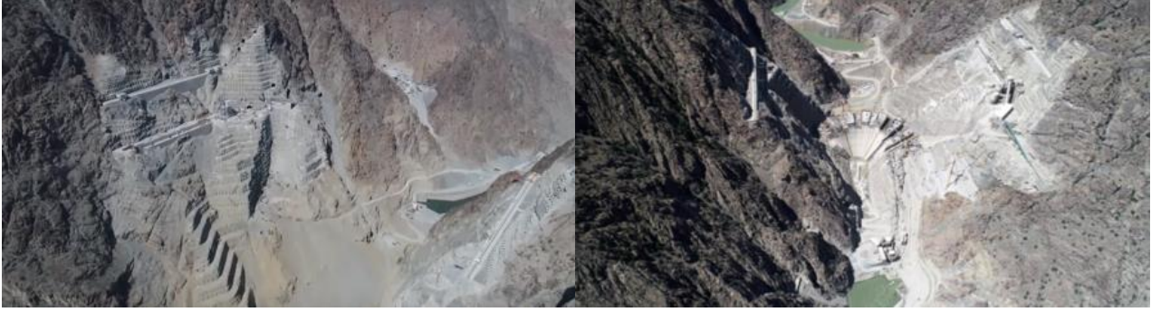
Şekil 6: Yusufeli barajı yapım aşaması görüntüleri (Foto: Artvin DSİ 26. Bölge Müdürlüğü İHA görüntüleri)
