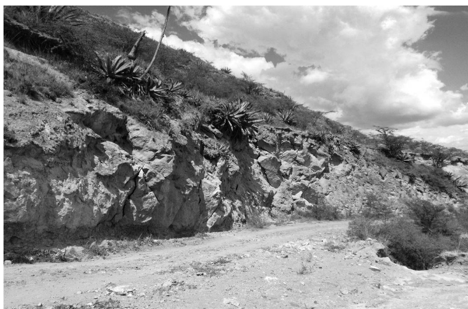
Рисунок 1. Подрезанная нижняя часть склона.
