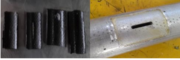
Şekil 5: İç basın sonucu, boru ve yamada oluşan hasar bölgeleri.
